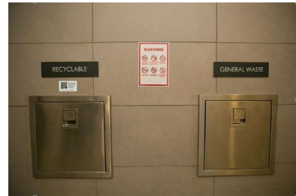
Abfallschacht und Recyclingschacht
